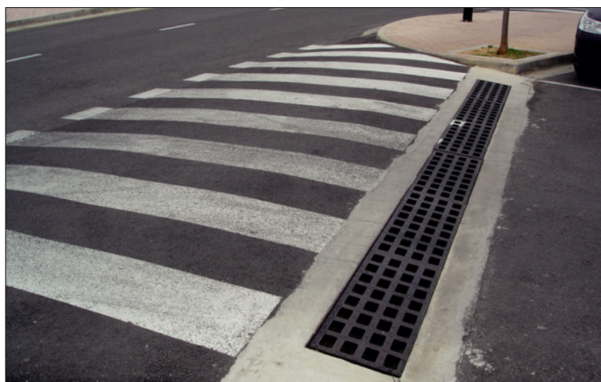
Canalización del agua en lomo.
